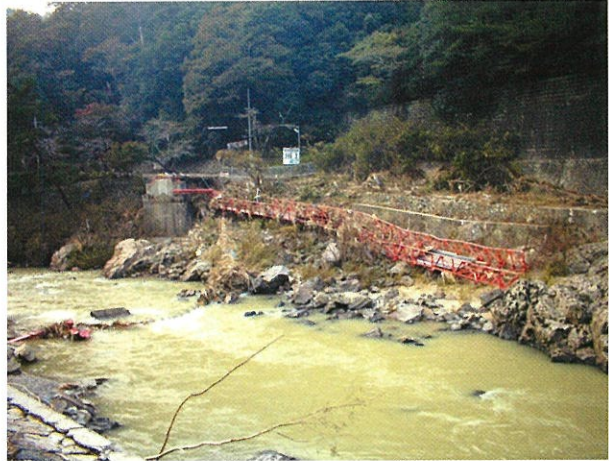
① 増水 ぞうすい で流された橋 はし
