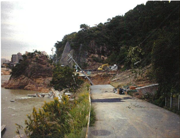
① 台風で流された道路
